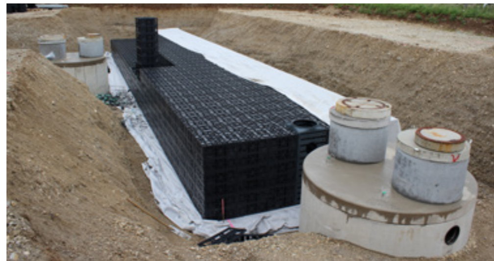
Der Anschluss erfolgte über zwei Zulaufrohre DN 300 mit zwei vorgesetzten Lamellenklärrern.
