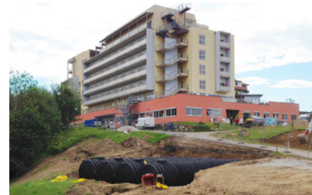
Der bis September 2019 abgeschlossene An- und Umbau der Privatklinik Laßnitzhöhe erforderte auch die den Kapazitäten angepasste Löschwasserbevorratung.
